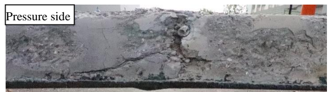
(d) Concrete at pressure side
